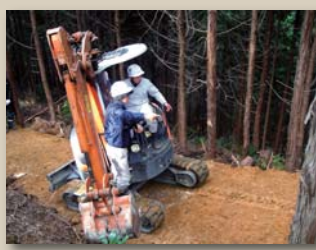
路網整備のエキスパートから指導を受ける北はりま森林組合の職員。座学では理論を、現場では地形や土の見方や山に負担をかけない工事方法などを学び、門柳山の路網整備を担う頼もしい人材になりました。
